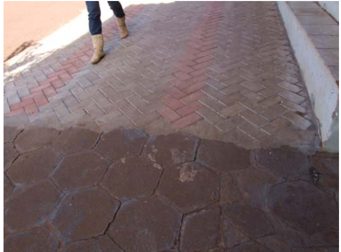
FIGURA 27- DESCONTINUIDADE NO CALÇAMENTO DA RUA Fonte: Autora 2009
