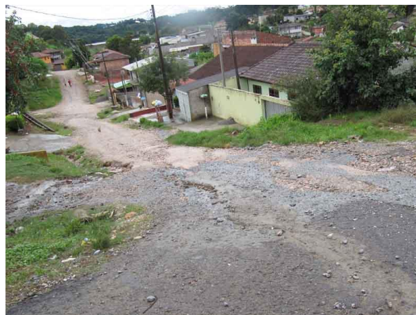
FIGURA 54 – VIA EM MAU ESTADO (letra b, Figura 52)
