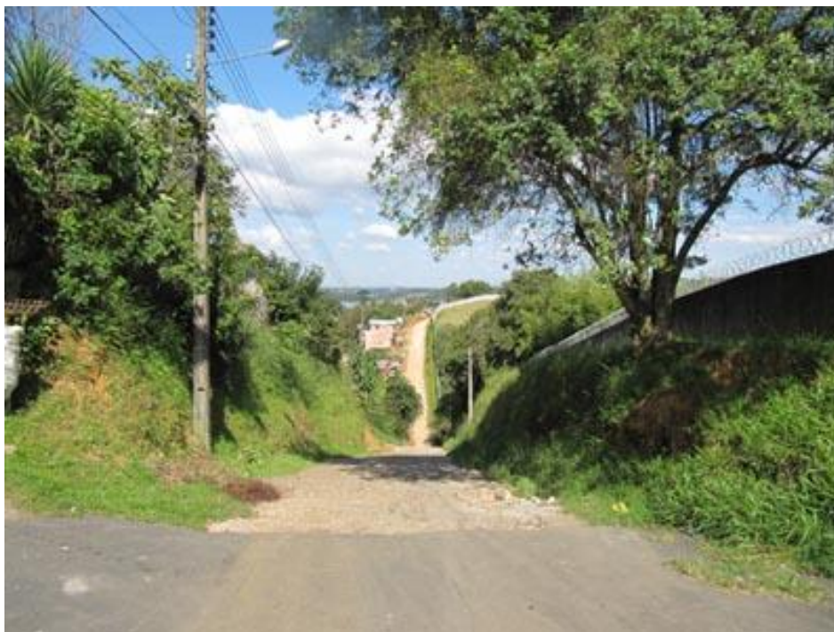
FIGURA 64 – VIA SEM PAVIMENTAÇÃO EM DESNÍVEL ACENTUADO
