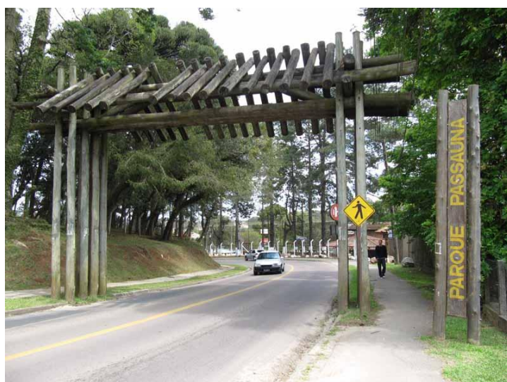
FIGURA 87 – PORTAL DO PARQUE COM EUCALIPTOS FALTANTES EM SUA COBERTURA
