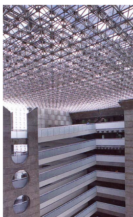
Figura 13 – Cobertura que parece levitar sobre as rampas e circulações (Foto: Carlos Geller)
