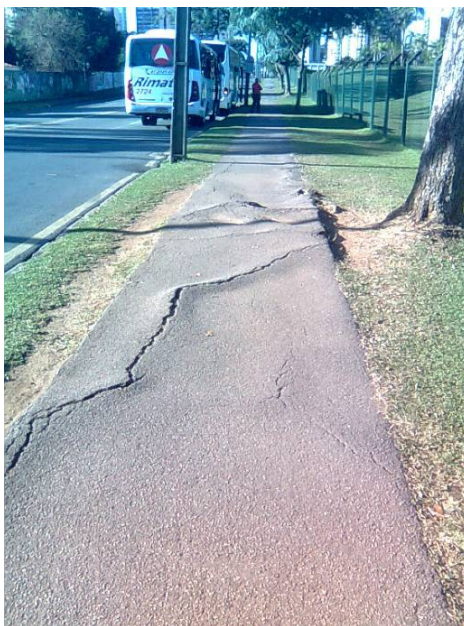
Figura 77. FALTA DE CONFORTO
