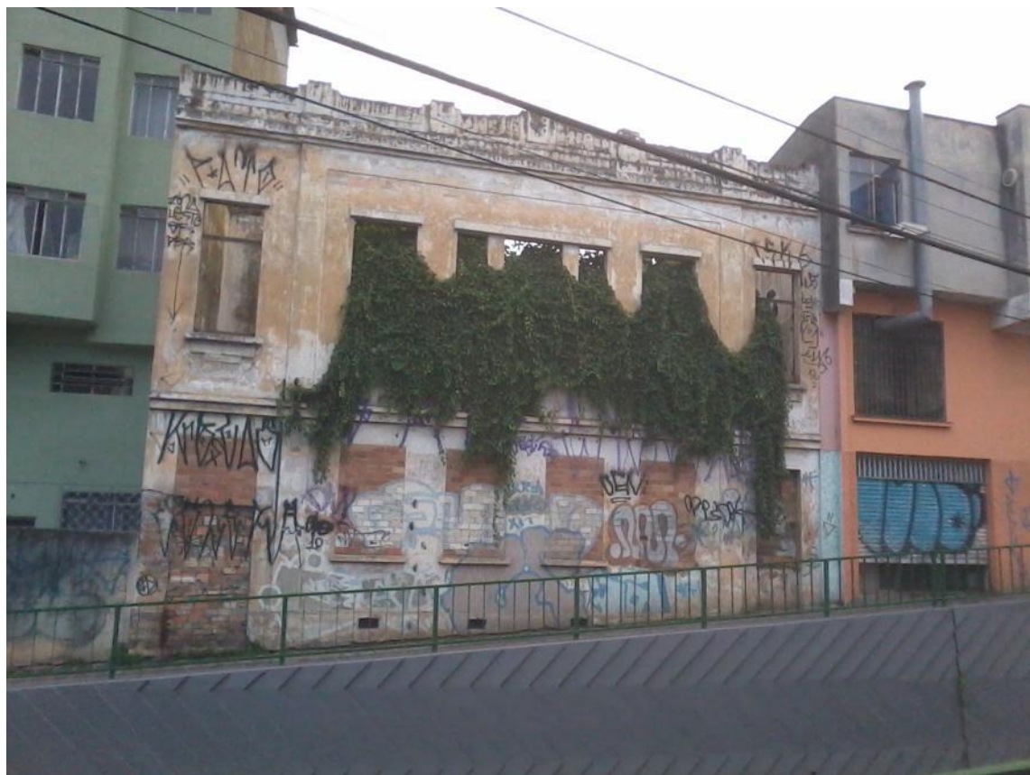
FIGURA 51 - EDIFICAÇÃO EM SITUAÇÃO DE ABANDONO – VISTA DA RUA 13 DE MAIO FONTE: O autor (2012)
