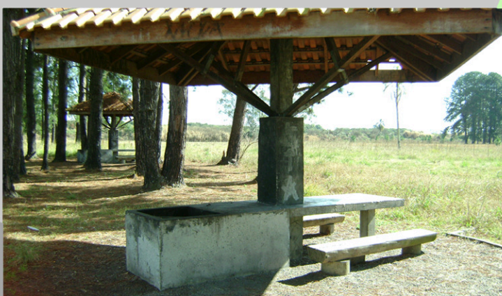
SITUAÇÃO ATUAL - CHURRASQUEIRAS DEGRADADAS
