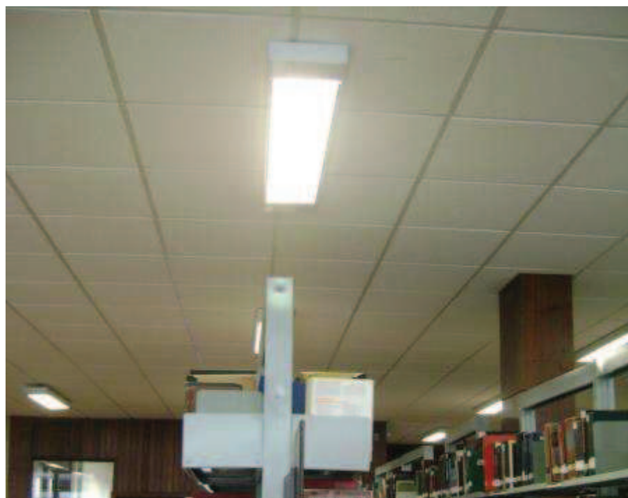
Figura 5.26 – Incompatibilidade entre o antigo projeto de iluminação e a nova disposição das estantes (Fonte: Acervo da autora, 2013).
