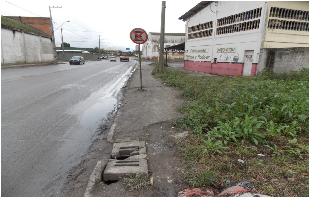
Figura 60: Trecho da ciclovia da Avenida Coronel Santa Rita em más condições.
