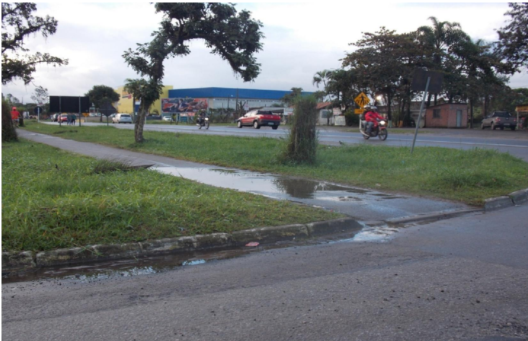
Figura 27: Ponto da ciclovia com problemas de drenagem.
