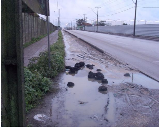
Figura 47: Trecho da ciclovia da Avenida Bento Rocha sem condições de uso.
