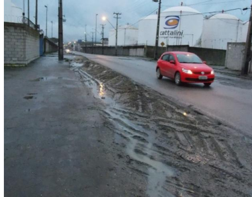
Figura 48: Trecho da ciclovia da Avenida Bento Rocha sem condições de uso.
