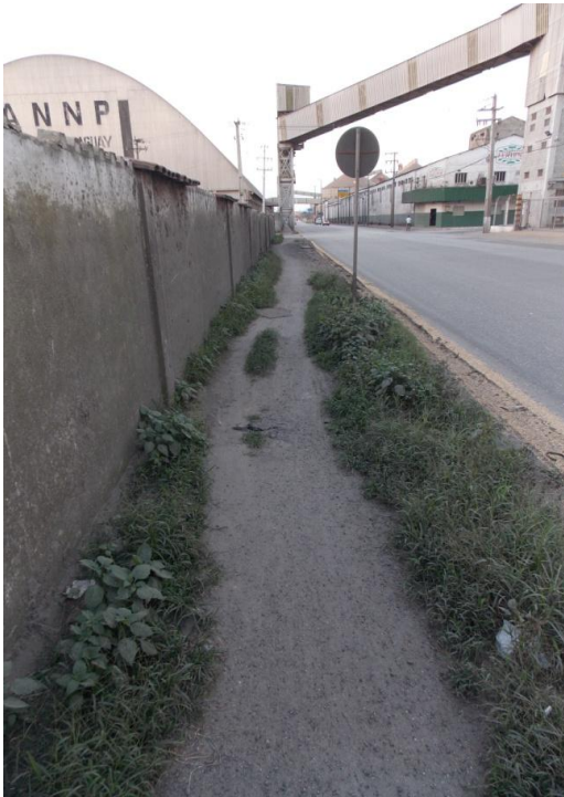
Figura 44: Trecho em más condições de limpeza conservação.
