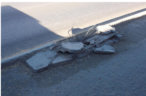
Figura 49: Boca de lobo destruída na ciclovia da Avenida Bento Rocha.
