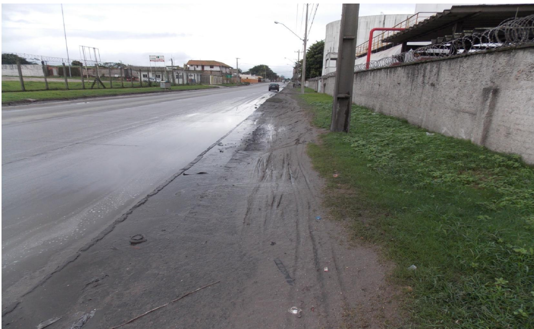
Figura 59: Trecho da ciclovia da Avenida Santa Rita com muita lama.
