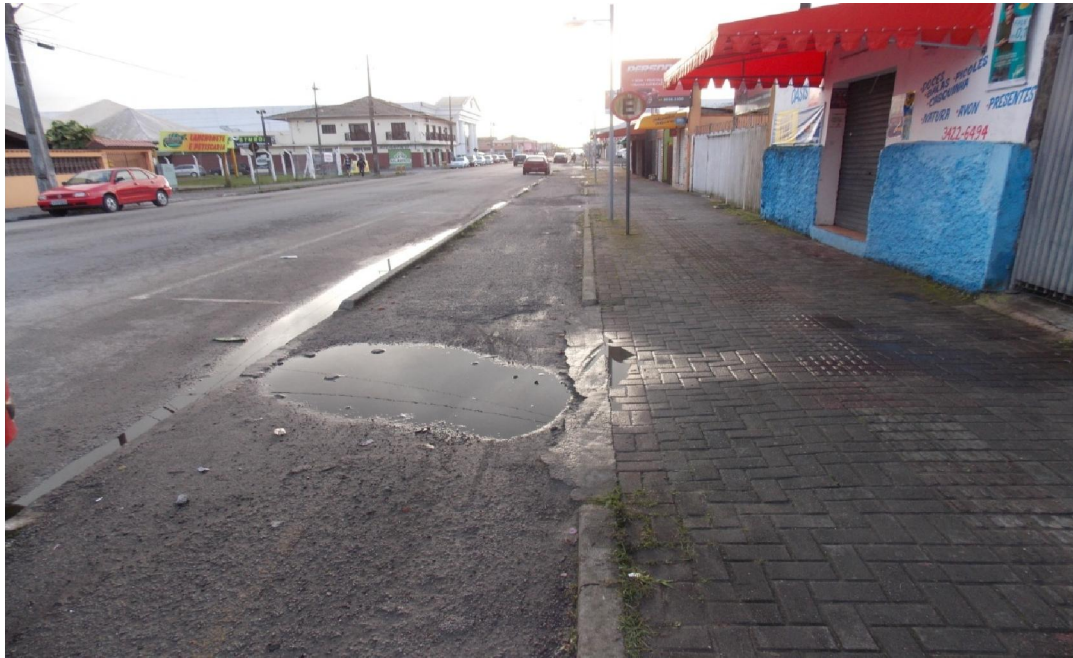
Figura 52: Problemas com drenagem na entrada de residência.
