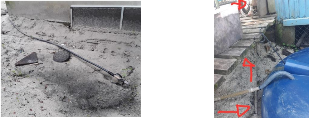
FIGURA 7 - PONTEIRA E CHEGADA EM RESERVATÓRIO EM RESIDENCIA NA POVOADO DE ILHA DAS PEÇAS
