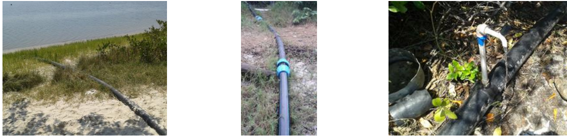
FIGURA 4 - DISTRIBUIÇÃO ÁGUA NA POVOADO DE ILHA DAS PEÇAS TUBULAÇÕES E PRIMEIRO PONTO DE ÁGUA DA POVOADO.
