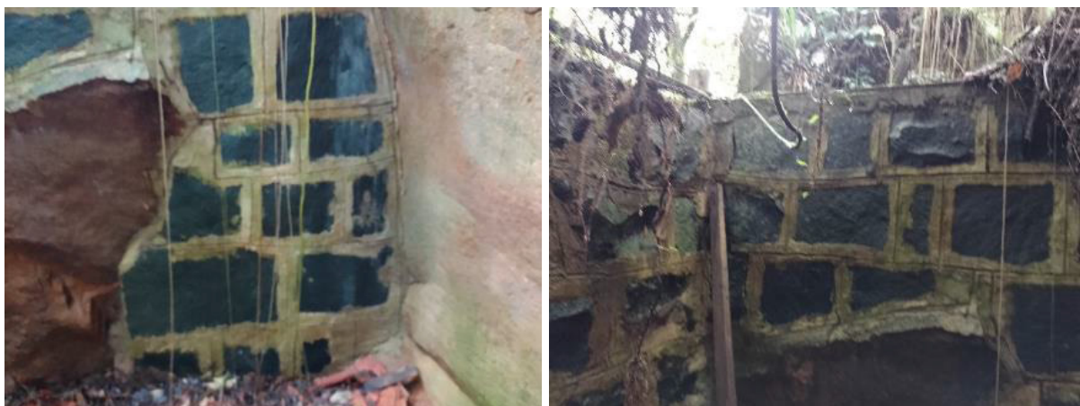
Figura 4.24 Registro de fragmentos de telhas no canto da capela, atualmente sem nenhuma cobertura.
