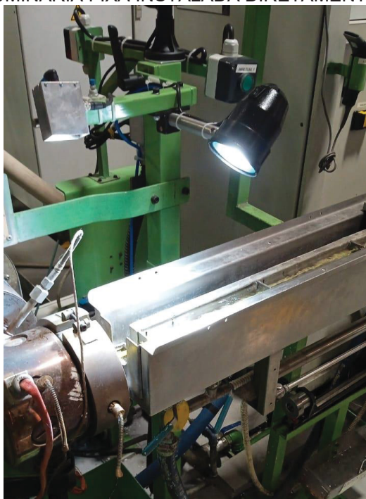
FIGURA 26 - LUMINÁRIA FIXA INSTALADA DIRETAMENTE SOBRE TUBO
