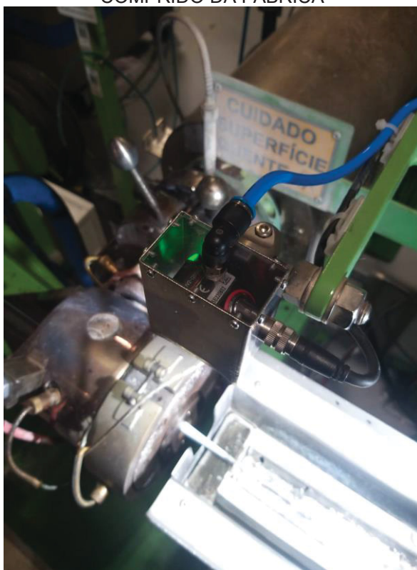
FIGURA 29 - ENCLAUSURAMENTO DO SENSOR COM CÂMARA DE PRESSÃO POSITIVA ALIMENTADA POR REDE DE AR COMPRIDO DA FÁBRICA
