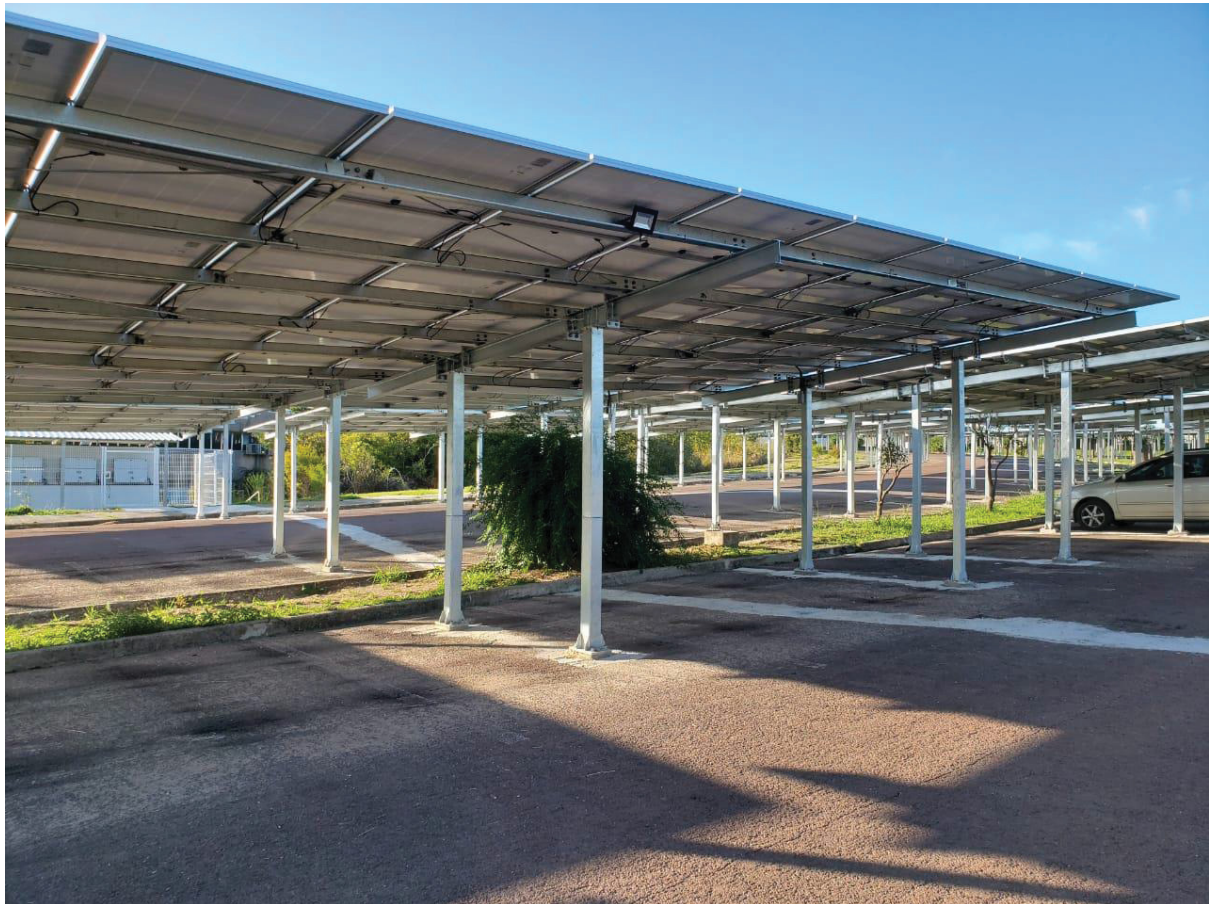
FIGURA 39 - CARPORT INSTALADO NA UNIVERSIDADE FEDERAL DO PARANÁ (A AUTORA, 2020).
