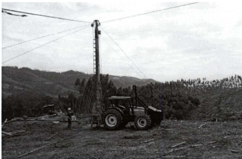
Quadro 9. Baldeio por Cabo Aéreo
