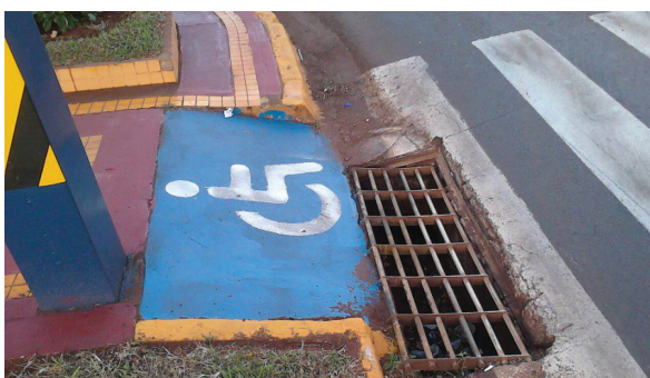
Figura 17 - Fotografia de uma rampa de acessibilidade irregular
