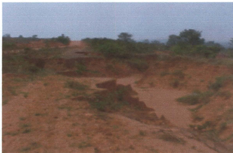
Figura 04 – Processo erosivo, após remoção da vegetação superficial aliado a ação das águas pluviais. Fonte: DGEO/2001.
