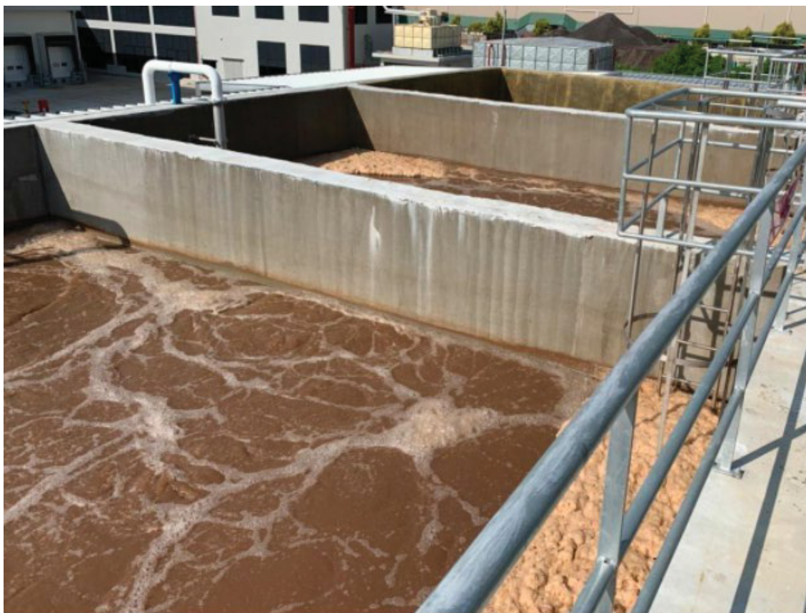
FIGURA 1 - ESTAÇÃO DE TRATAMENTO DE EFLUENTES DE UMA INDÚSTRIA
