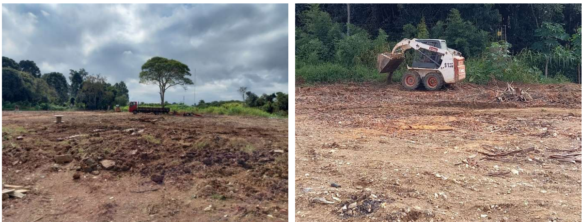
Figura 7 – Visão de oeste a leste da área com resíduos sólidos depositados no solo e limpeza e preparação do solo com o auxílio da Bobcat S100.
