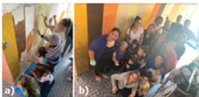
Figura 70 - Aplicação das tintas na parede externa (a) e parede externa com a pintura finalizada (b)
