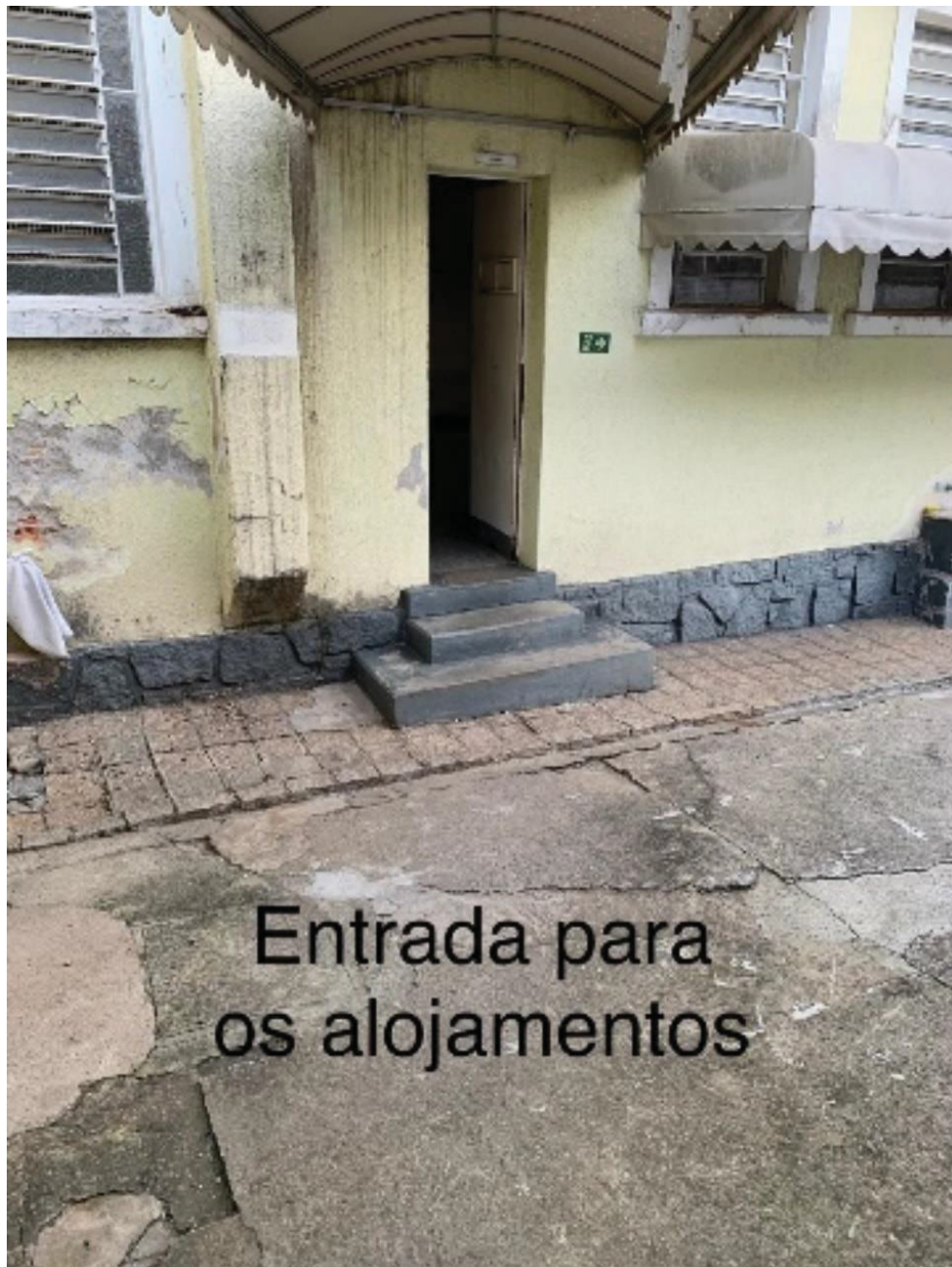
Figura 6 - Entrada área residencial
