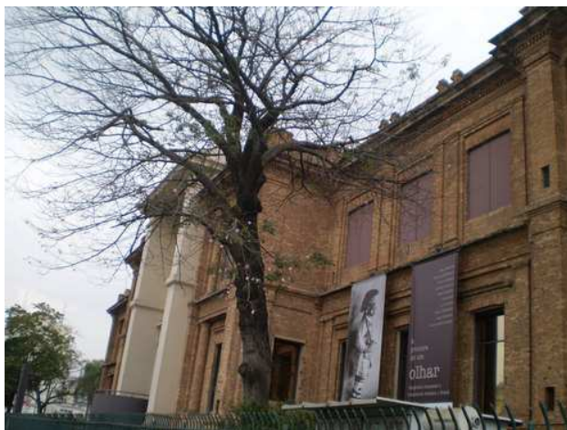
FIGURA 40: Vista da Fachada da com as esquadrias vedadas com chapa metálica. Fonte: Goolge Earth (2013)
