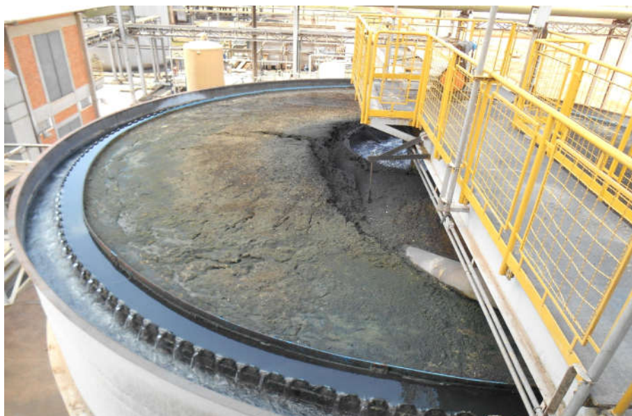
Figura 5 – Tanque de tratamento.
