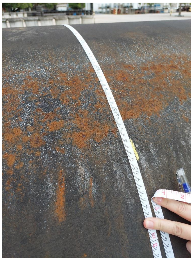
Figura 60 - Presença de ferrugem na superfície do tanque na leitura de uma seção
