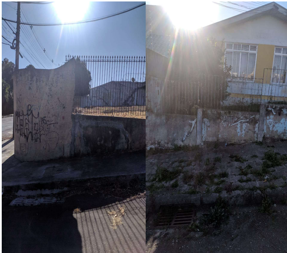
FIGURA 7 - FISSURAS NOS MUROS
