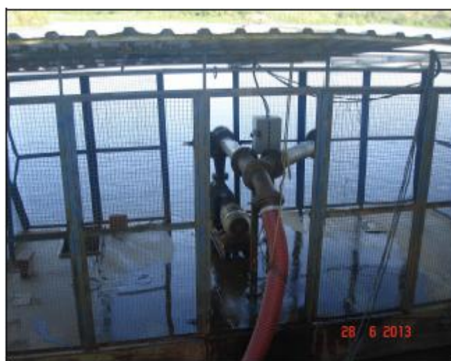
Figura 31: Sistema de captação da ETA Santa Rita Fonte: PMSB GV, 2013
