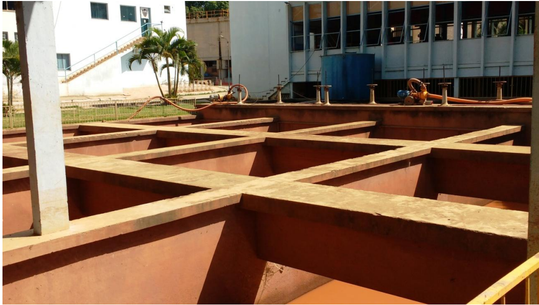
Figura 58: Desarenador da ETA Central Fonte: Acervo Próprio, 2016
