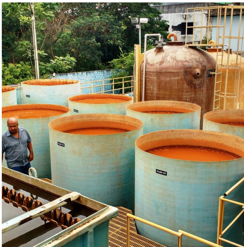
Figura 66: Visão Geral da ETA Vila Isa Fonte: Acervo Próprio, 2016
