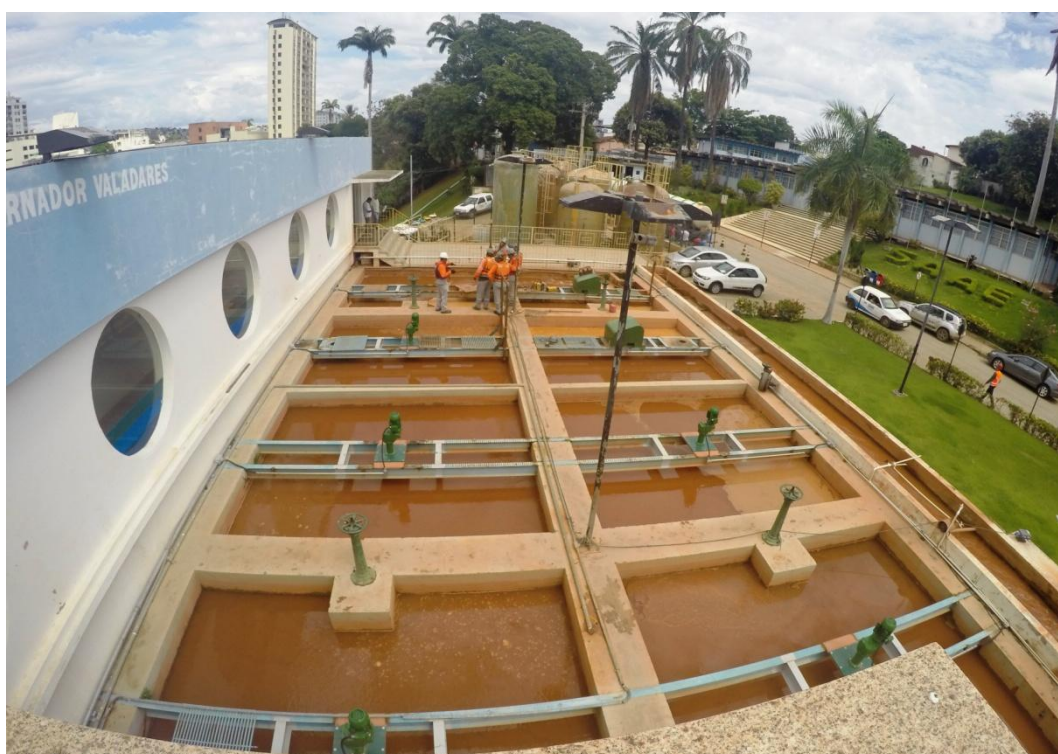
Figura 62: Vista dos floculadores da ETA Central, com os novos agitadores mecânicos instalados
