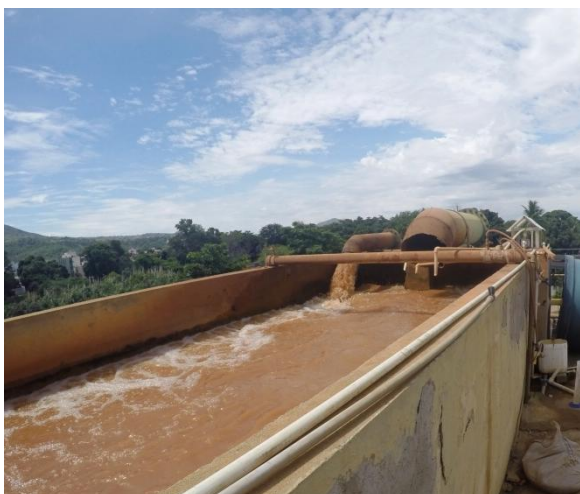
Figura 60: Entrada de água bruta na ETA Fonte: Acervo Próprio, 2016
