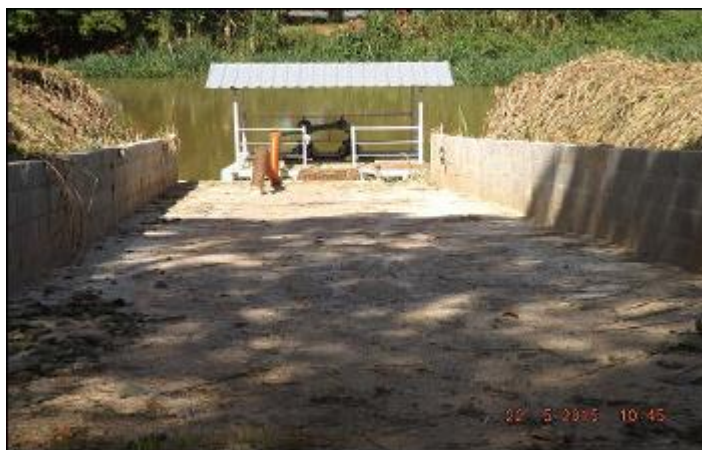
Figura 33: Sistema de Captação da ETA Recanto dos Sonhos Fonte: PMSB GV, 2015
