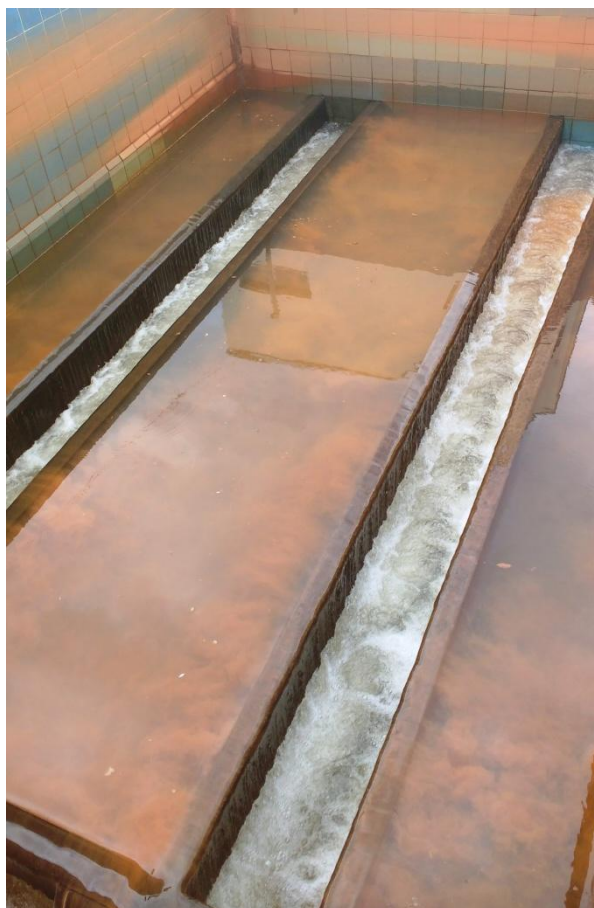
Figura 65: Filtro da estação em processo de retrolavagem Fonte: Acervo Próprio, 2016
