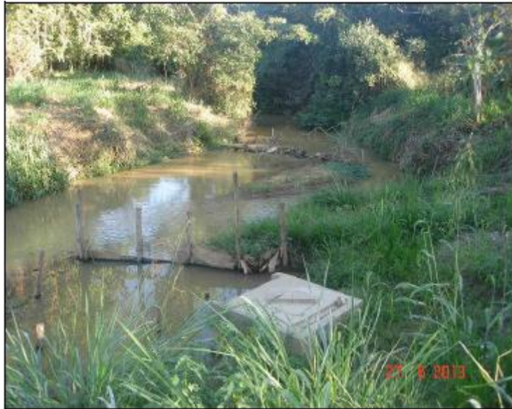
Figura 29: Sistema de captação de água bruta da ETA Penha. Fonte: PMSB GV, 2015
