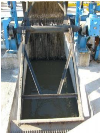
Figura 6 - Gradeamento da ETE Mulembá em Vitória - ES. Fonte: Cesan
