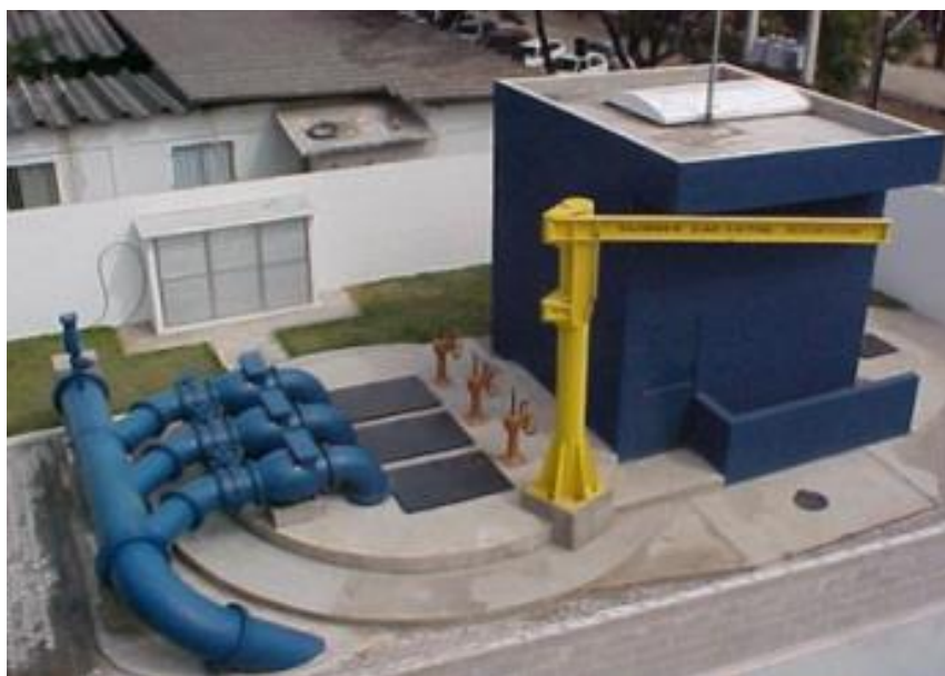
Figura 5 - Estação Elevatória. Fonte - Cesan.
