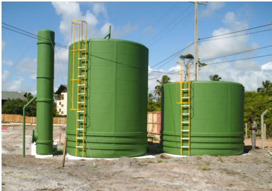
Figura 8 - Reator UASB. Fonte: Fibra Técnica
