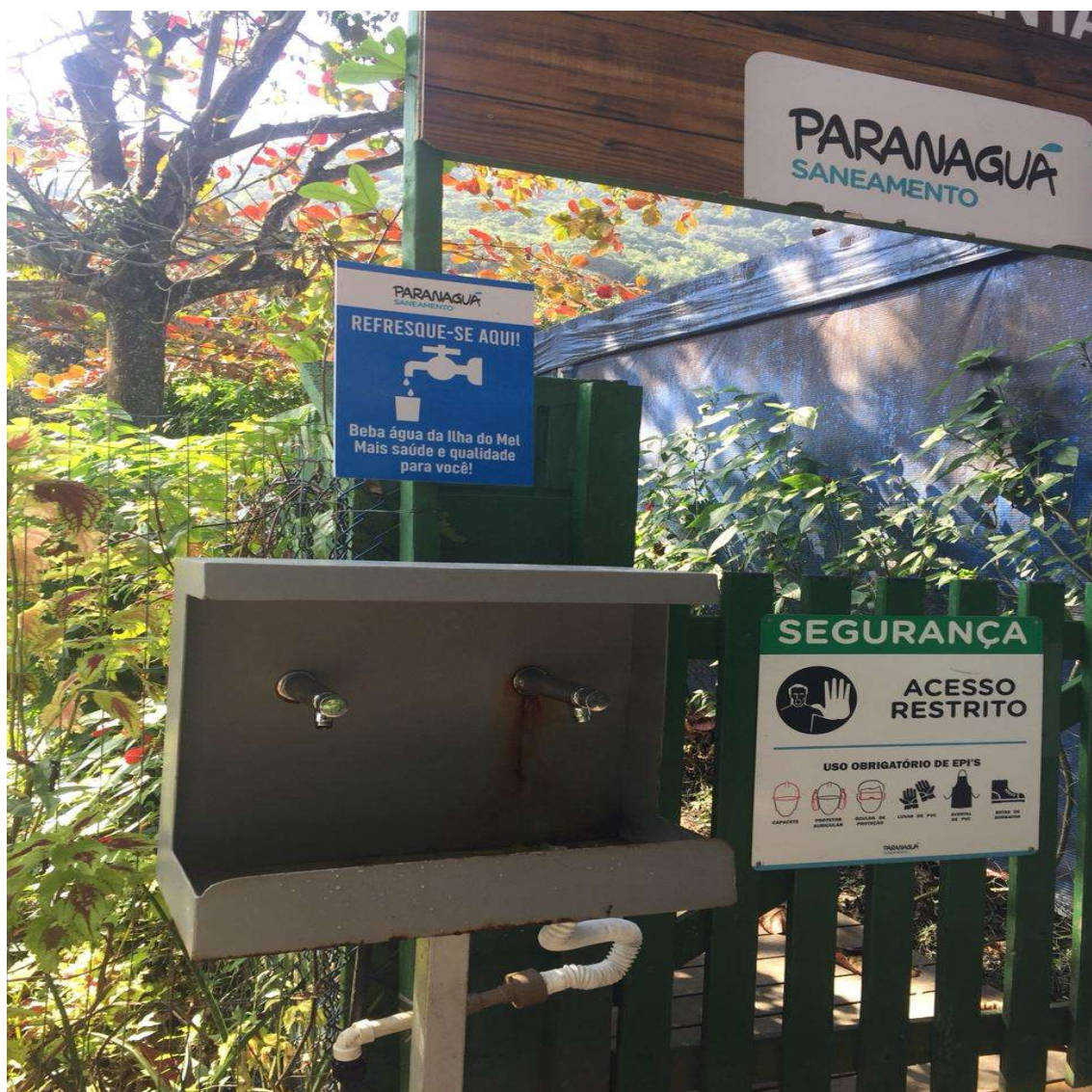
Figura 16 – Estação de tratamento de água de Encantadas, Ilha do Mel
