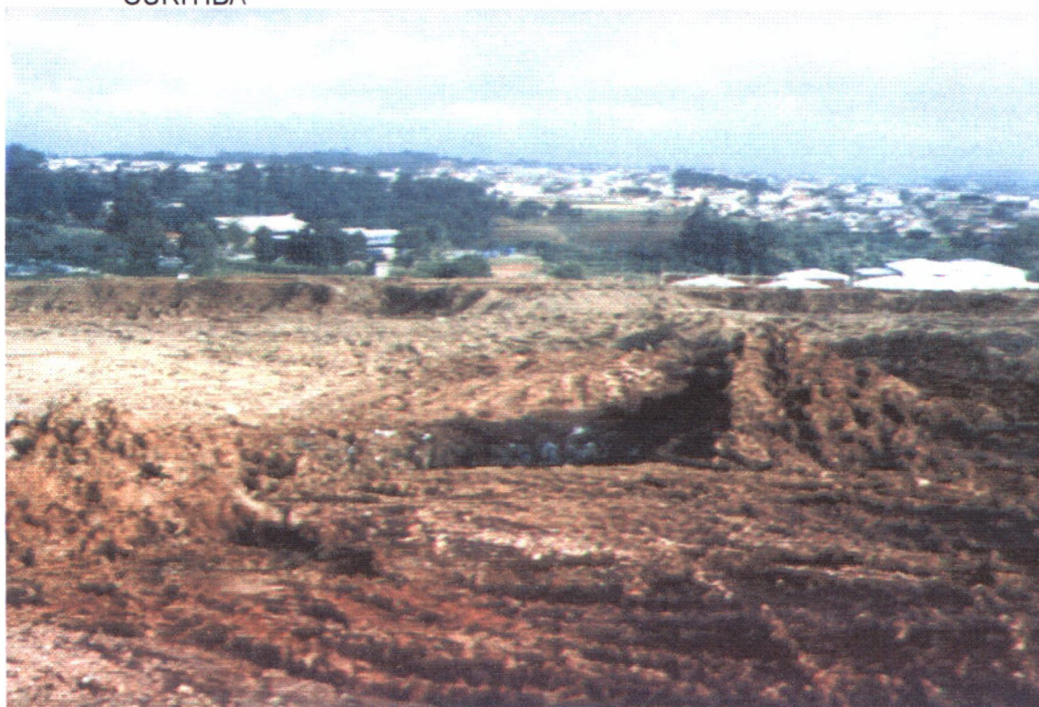
FIGURA 09 – ATERRAMENTO DE RSSS EM VALAS SÉPTICAS NO MUNICÍPIO DE CURITIBA
