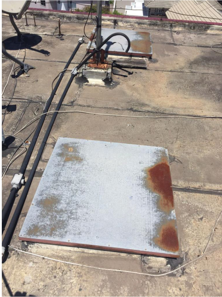
FIGURA 23 - Reservatórios superiores, parte externa
