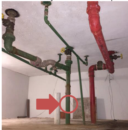
FIGURA 27 - Ponto de instalação da sonda de qualidade de água
