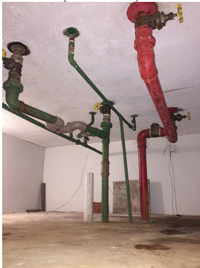
FIGURA 22 - Sala de transição reservatórios superiores e abastecimento
