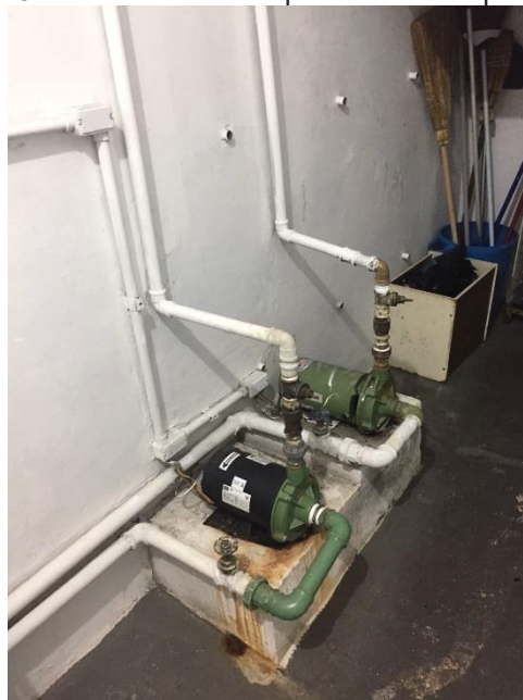
FIGURA 18 - Bombas de recalque sala de máquinas
