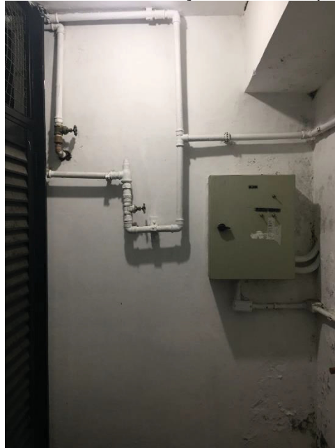
FIGURA 17 - Quadro de automação sala de máquinas
