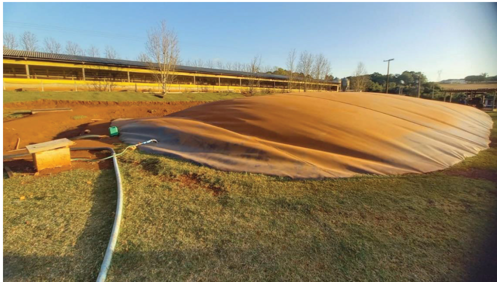
FIGURA 12 – BIODIGESTOR DA PROPRIEDADE 1
