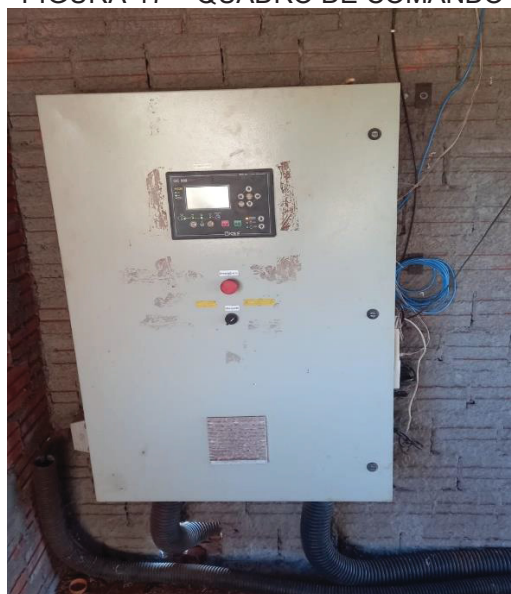
FIGURA 17 – QUADRO DE COMANDO
