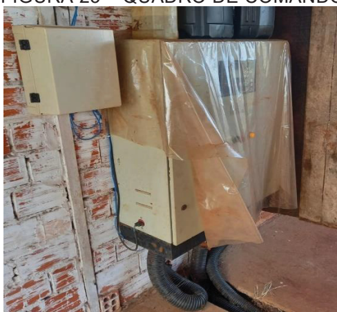
FIGURA 23 – QUADRO DE COMANDO
