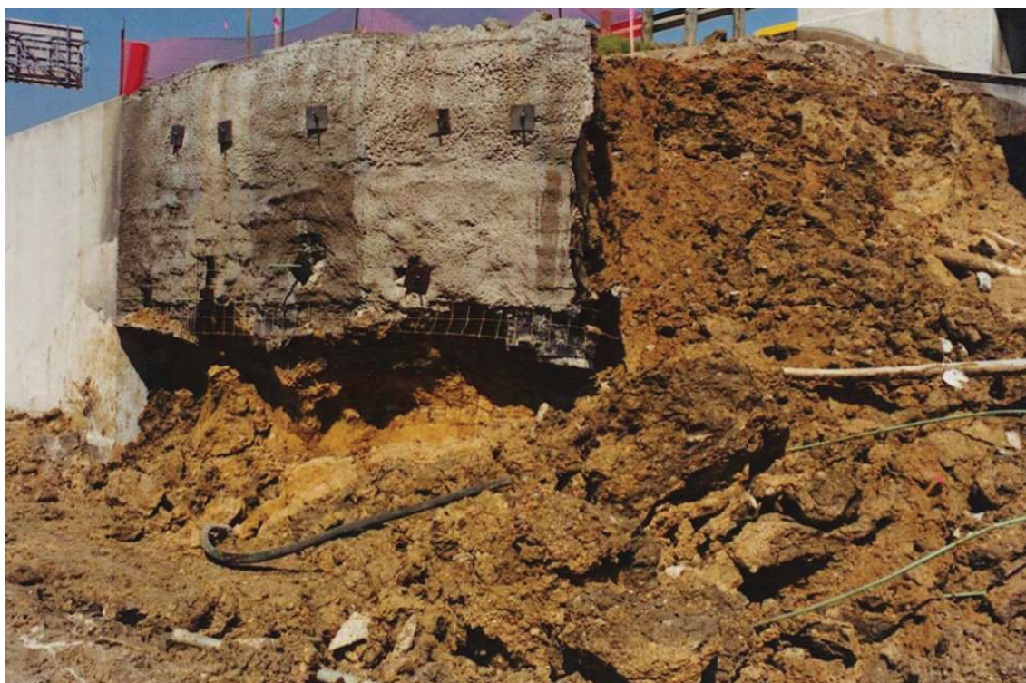
Figura 2.8 – Falha em solo grampeado nos EUA
