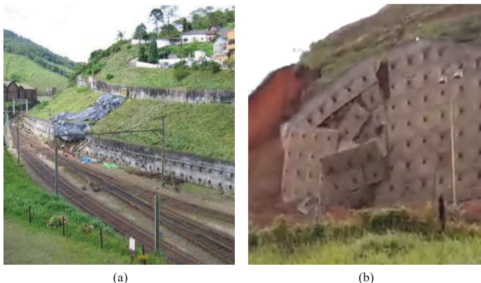
Figura 2.15 – Ruptura de cortinas atirantadas em ferrovias
