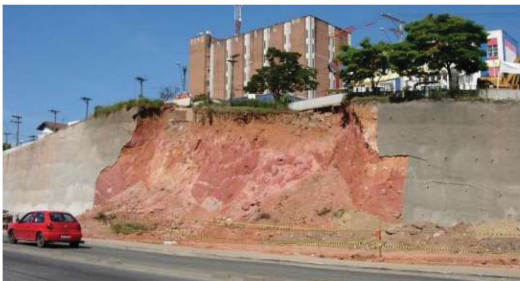
Figura 2.6 – Falha em solo grampeado na rodovia raposo Tavares-SP
