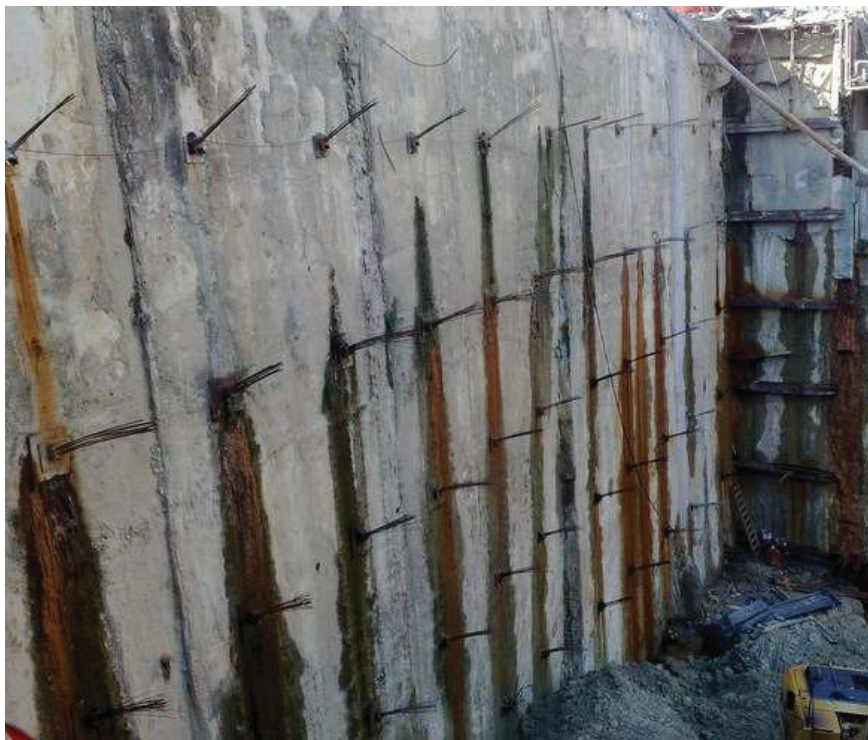
Figura 2.12 – Saída de água pela cabeça do tirante
