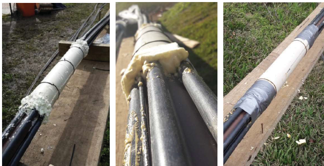
Figura 3.36 – Falha com ar nas cordoalhas
