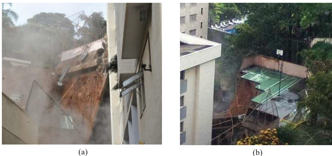
Figura 2.16 – Ruptura de cortina atirantada em Belo Horizonte – MG
