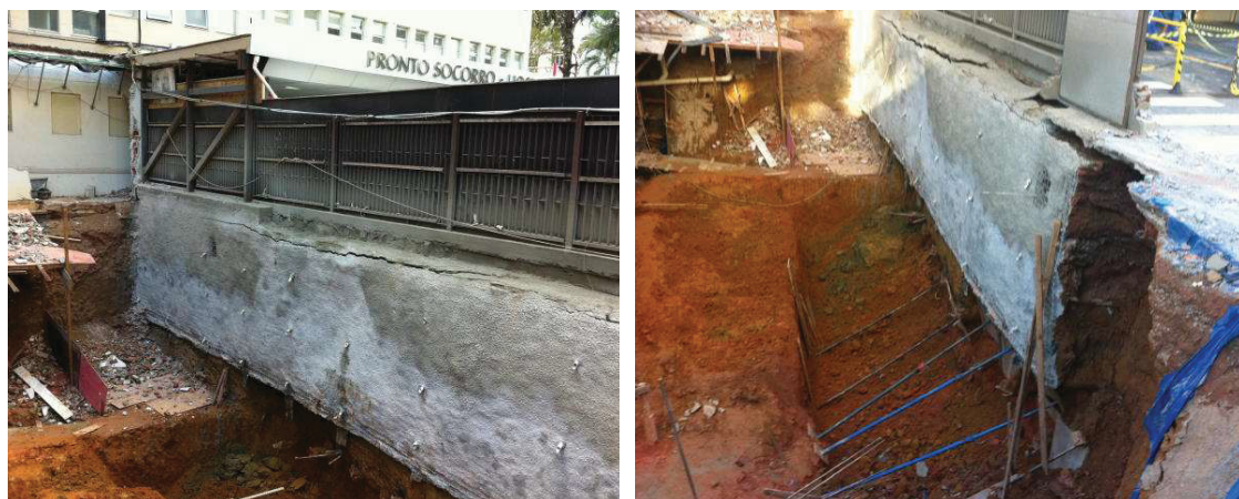
Figura 2.7 – Colapso de solo grampeado em área urbana
