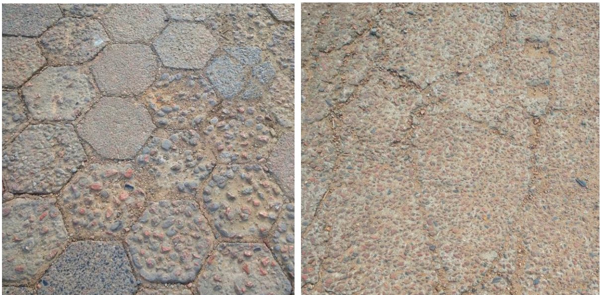
FIGURA 19: DESGASTE SUPERFICIAL POR ABRASÃO EM PISOS DE CONCRETO
