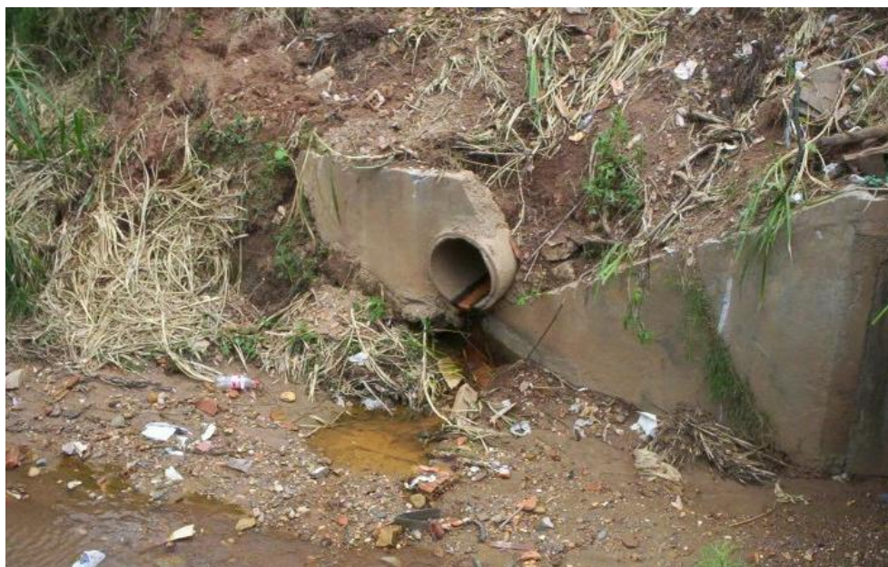
FIGURA -23 LANÇAMENTO DE ÁGUAS SERVIDAS
