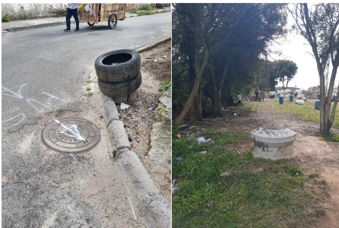
FIGURA 29 – POÇOS DE VISITA E ELEVATÓRIA DE ESGOTO NAS MARGENS DO CÓRREGO VILA FORMOSA - VILA LEÃO – MUNICÍPIO DE CURITIBA – 2022
