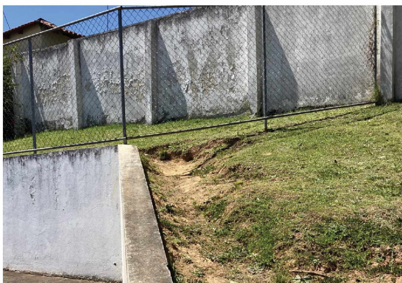
FIGURA 82 – MARCAS DEIXADAS NO TERRENO
