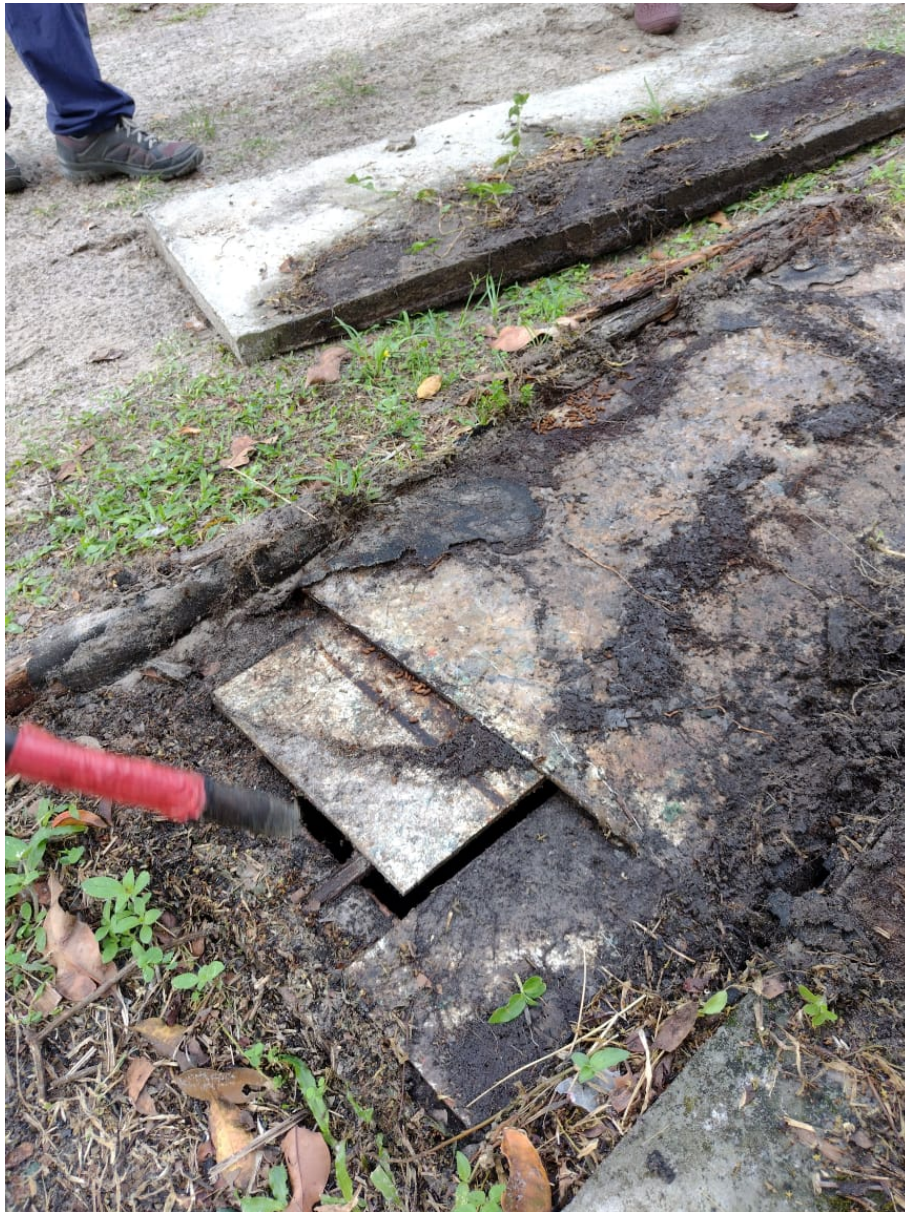
FIGURA 27 – FOSSA DESATIVADA SENDO ABERTA E BARATAS SAINDO DE DENTRO
