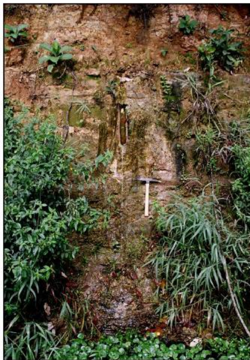
Foto 19: Exudação localizada de água no talude a montante (SW), no trecho 4.
