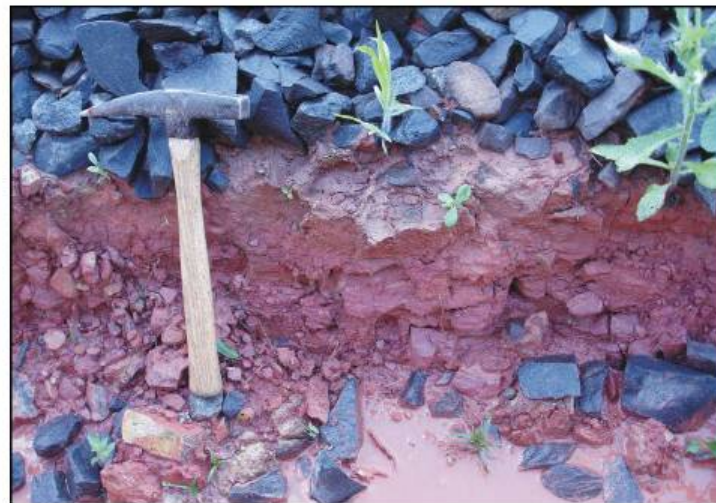
Foto 13: Perfil da infraestrutura no trecho 2. Observa-se que não há material selecionado nem sublastro.
