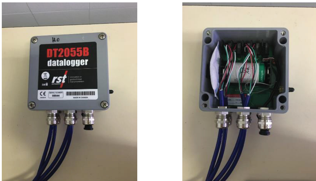
FIGURA 37 – DATALOGGER PARA AQUISIÇÃO DE DADOS DOS PIEZÔMETROS ELÉTRICOS
