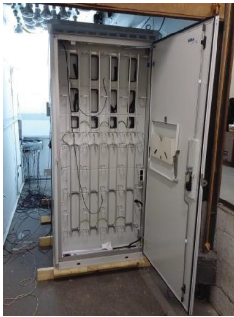
Figura 3: Vista interna DG direita
