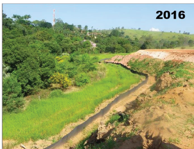
Figura 20 - Área antes do plantio, sem vegetação de proteção nos taludes.
