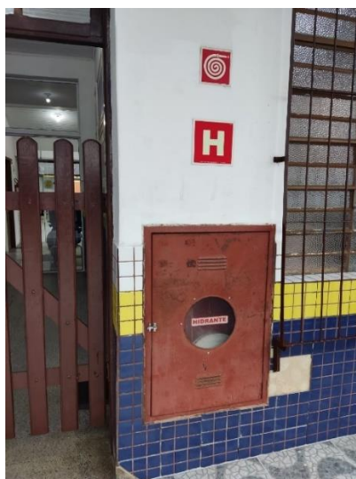
Figura 45 - Abrigo de incêndio sinalizado próximo a saída de emergência
