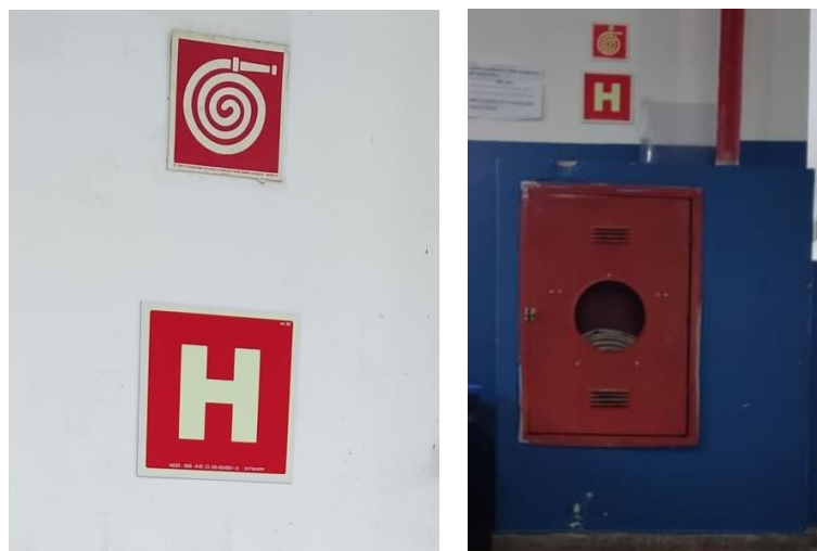
Figura 34 - Sinalização Conjunta de Hidrante
