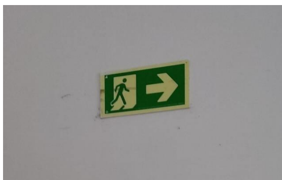
Figura 33 - Placa de sinalização de orientação e salvamento no corredor
