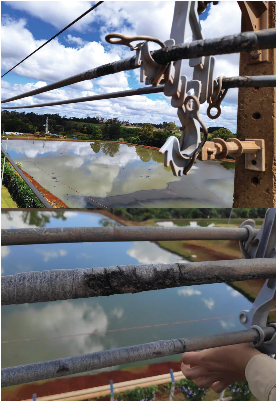
Figura 14 – Fotografia de trecho de linha compacta de 35 kV degradada por trilhamento elétrico
