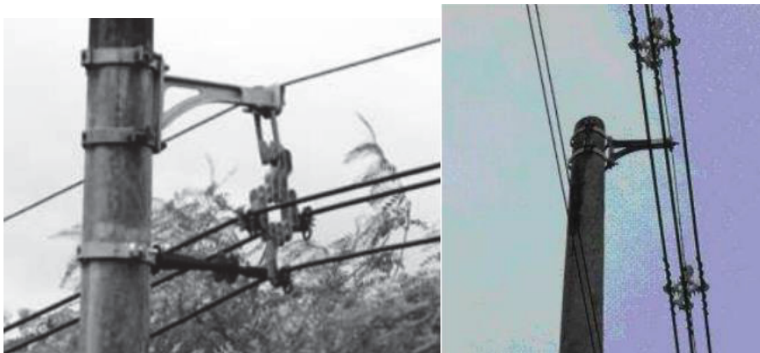
Figura 2 – Imagens com exemplos de trechos redes compactas
