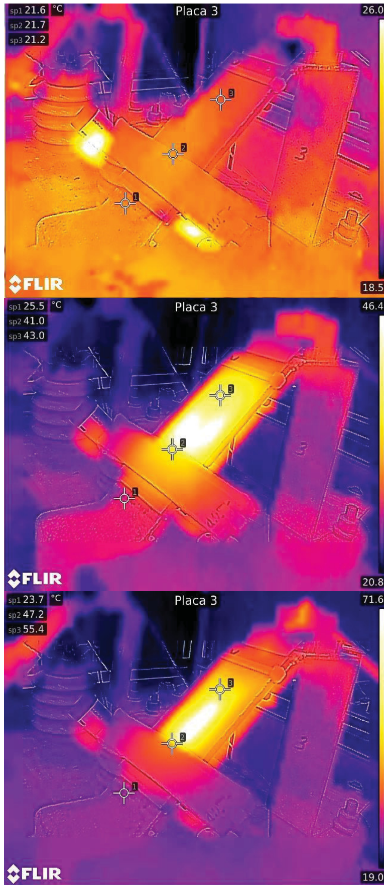
Figura 54 - Imagem térmica do processo de trilhamento elétrico Fonte: O Autor, 2019
