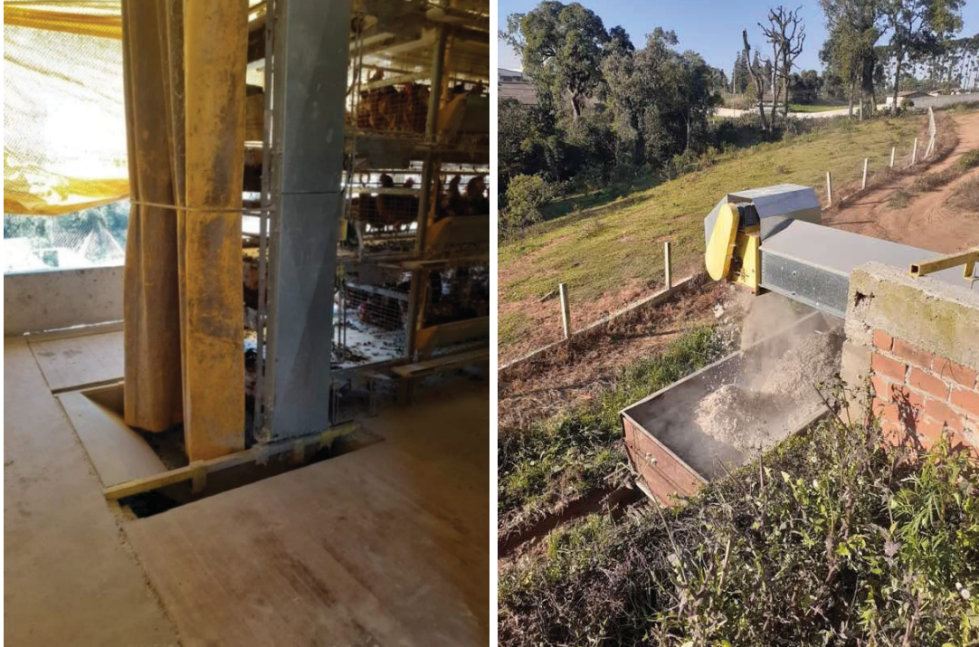
Figura 16 e Figura 17 - Sistema de transportadores de esterco
