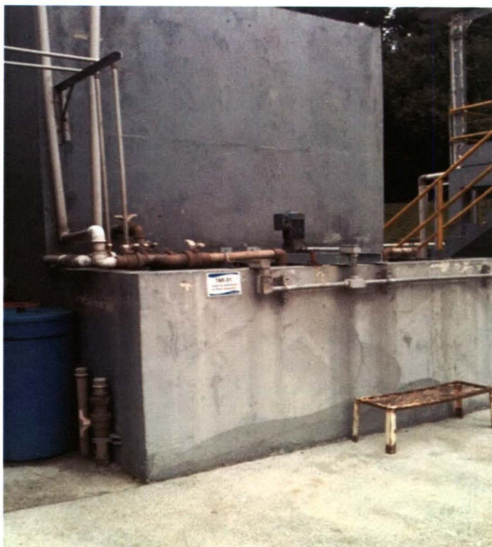
TANQUE QUE ALIMENTA OS REATORES
