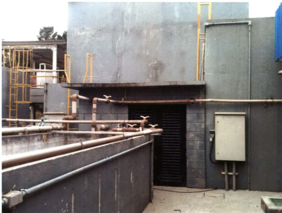
SALA DOS SOPRADORES – LOCAL ONDE FICAM OS 2 MOTORES ( AR QUE MISTURA LODO E EFLUENTE)
