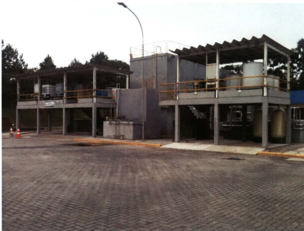
VISÃO GERAL DA ESTAÇÃO DE TRATAMENTO DE ESGOTO
