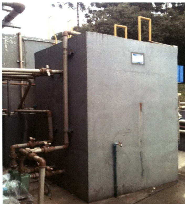
DECANTOR – LOCAL ONDE SEPARA O LODO DO EFLUENTE.
