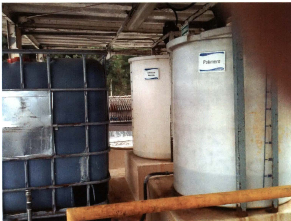
TANQUES DE PREPARO DOS PRODUTOS QUÍMICOS UTILIZADOS NO TRATAMENTO.
