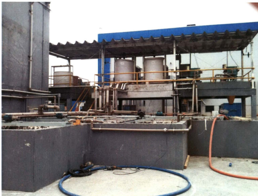
TANQUES DE ÁGUA COM RESINA E POÇO DE LODO. NESTE LOCAL É ONDE OCORRE O TRATAMENTO QUÍMICO DA RESINA
