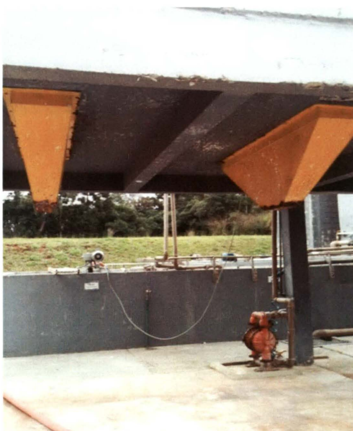
FILTRO PRENSA FÍSICO QUÍMICO. SAÍDA DO LODO PARA DESTINAÇÃO.
