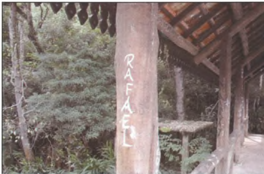
Figura 12 - PICHações NA PONTE DA CACHOEIRA.
