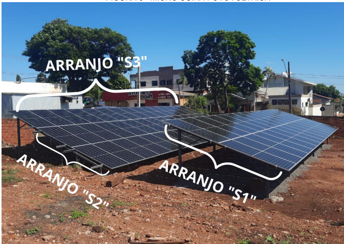
FIGURA 9– MICRO USINA FOTOVOLTAICA
