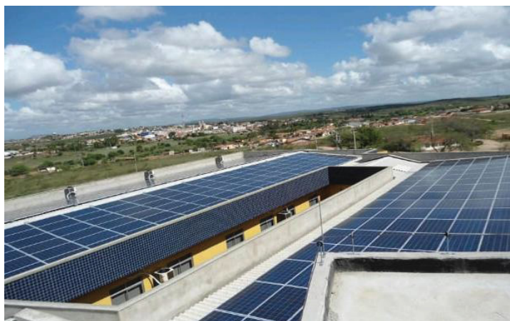
Figura 7 – Usina fotovoltaica do IFRRN Campus São Paulo do Potengi. Fonte: Wanderley (2017).
