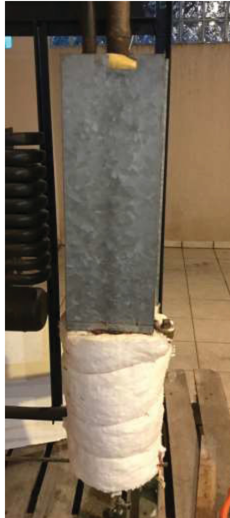
Figura 10: Trocador de Calor e Absorvedor com isolamento térmico.
