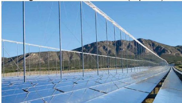
Figura 6: Usina CSP Fresnel (Espanha)
