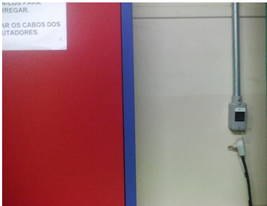
FIGURA 5: Armário desconectado da tomada.
