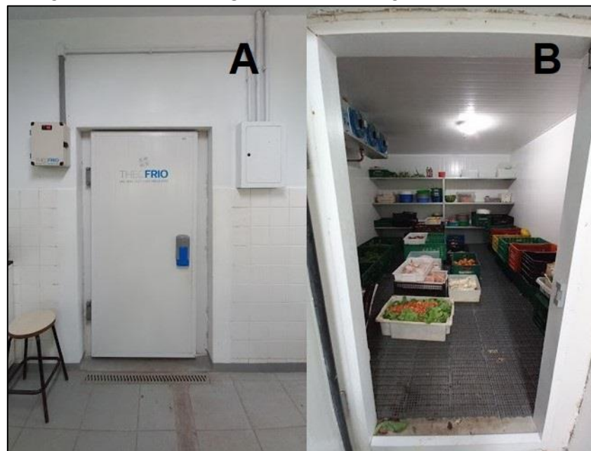
FIGURA 19: CÂMARA FRIA PARA ARMAZENAMENTO DE ALIMENTOS PERECÍVEIS DO SETOR DE NUTRIÇÃO DO ZOOLOGICO MUNICIPAL DE CASCAVEL-PR. A – VISTA EXTERNA DA CÂMARA FRIA. B- VISTA INTERNA DA CÂMARA FRIA.
